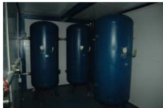
Установка внутри БКК
